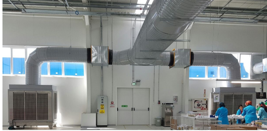
Hemak Formahane Bölümü HVAC Sistemi (80.000 m³/h) Uygulaması
